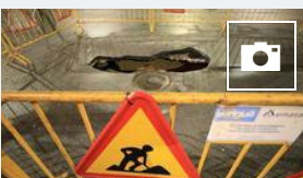
Aparece un socavón de varios metros de
