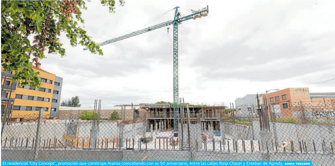
El residencial 'City Concept', promoción que construye Aransa coincidiendo con su 50 aniversario, entre las calles Rosa Chacel y Esteban de Ágreda. SONIA TERCERO
